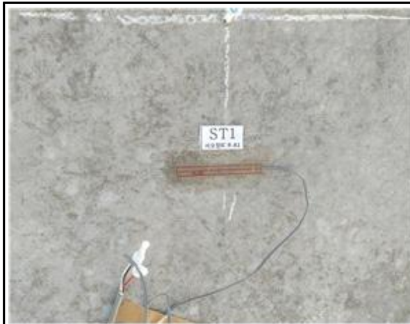
변형률계 설치 현황
